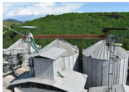
Gráfica 4. Fábrica de Alimento Balanceado, Silos y Tolvas Fuente: Genética Nacional S.A
